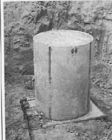
Vue de la chambre de visite en bordure de champ
